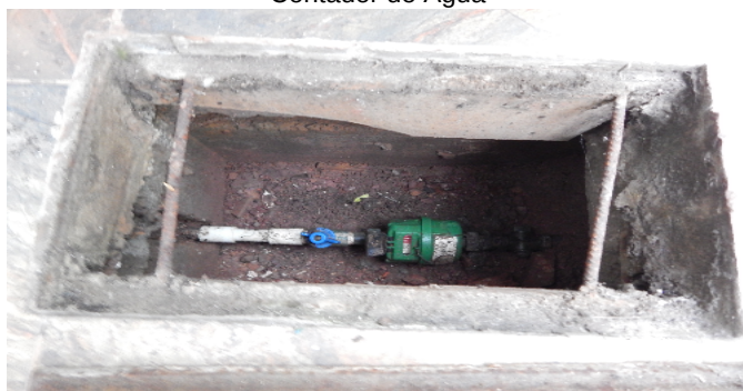
Contador de Agua
