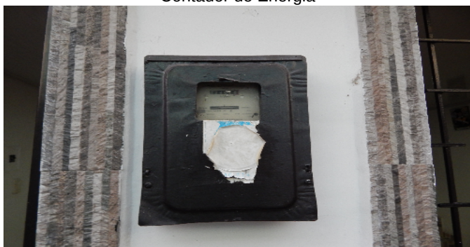
Contador de Energia
