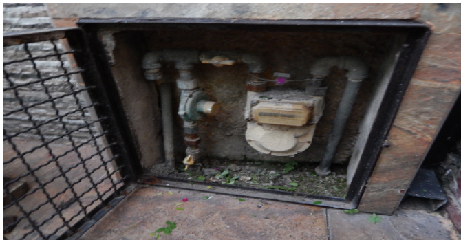
Contador de Gas
