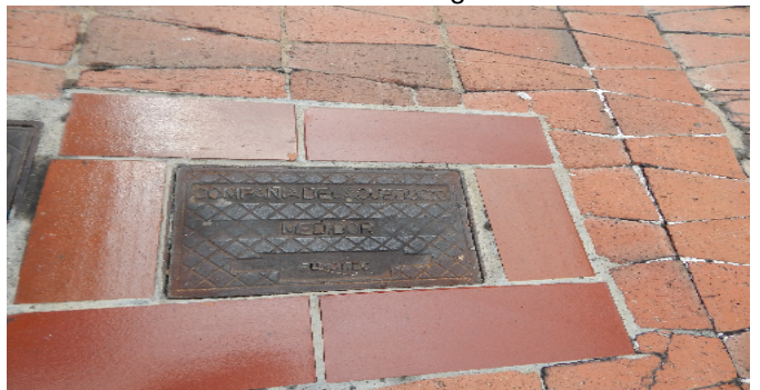
Contador de Agua
