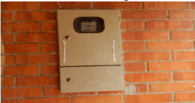
Contador de Energia
