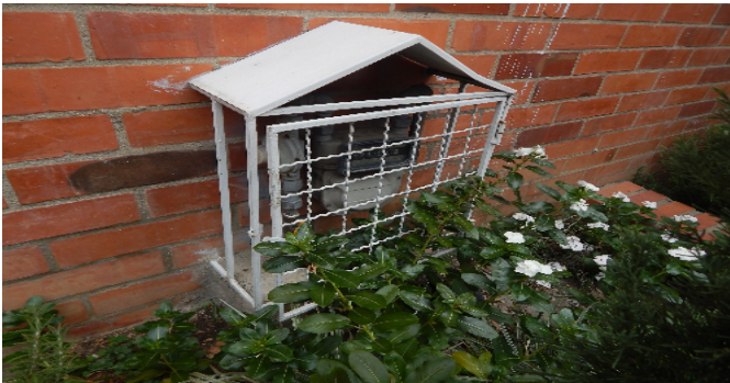
Contador de Gas
