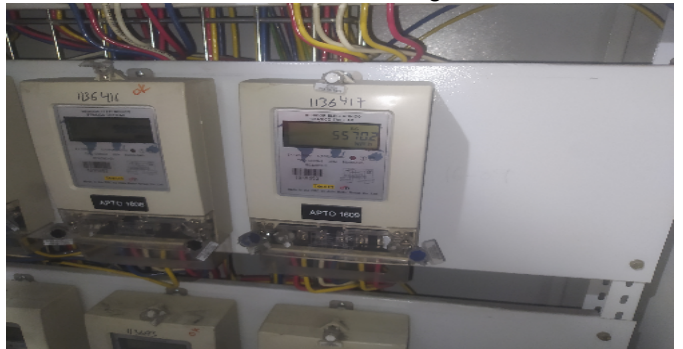
Contador de Energia
