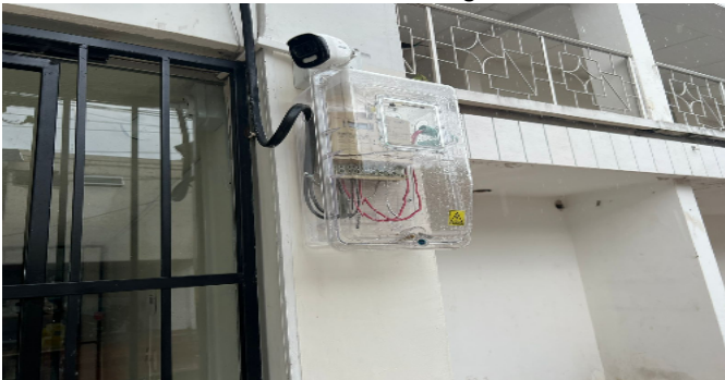
Contador de Energia
