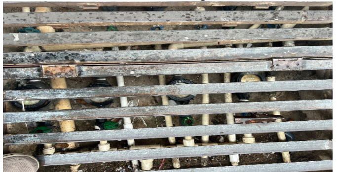
Contador de Agua
