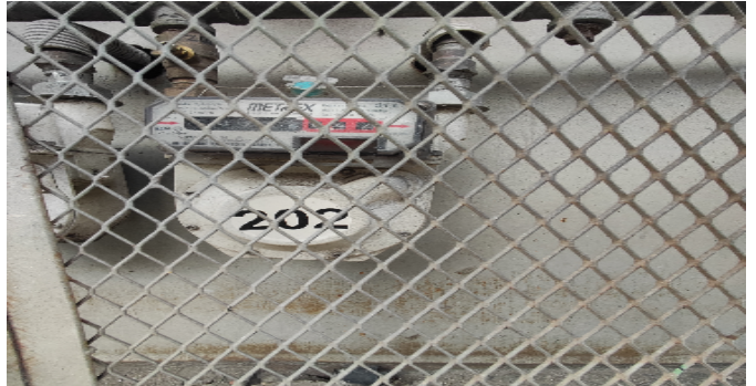
Contador de Gas
