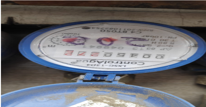
Contador de Agua
