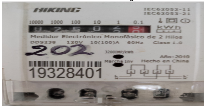
Contador de Energia
