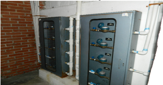
Contador de Agua
