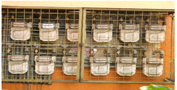
Contador de Gas
