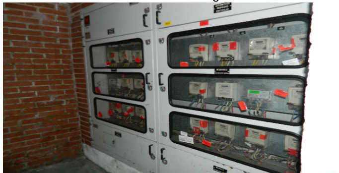
Contador de Energia
