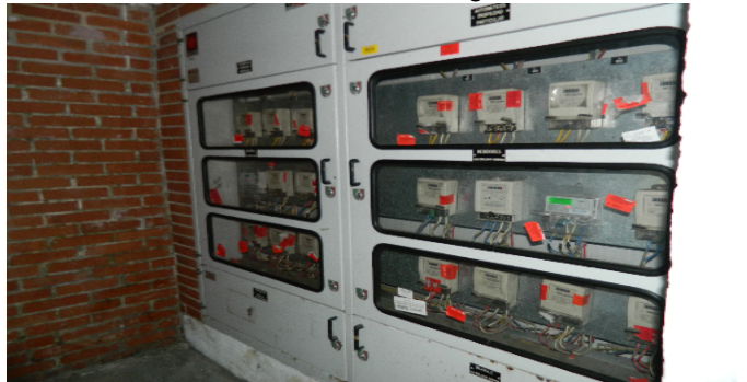
Contador de Energia
