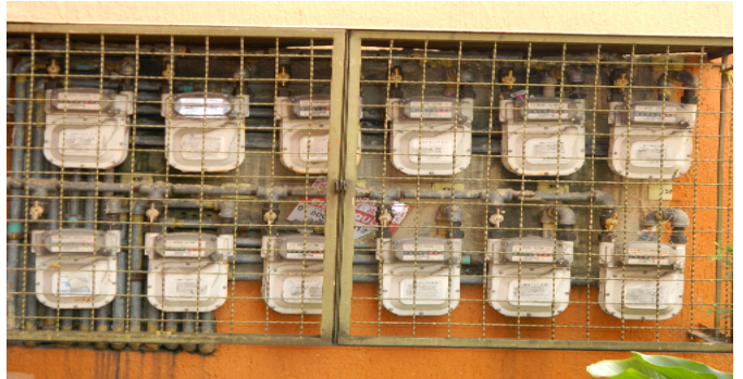
Contador de Gas
