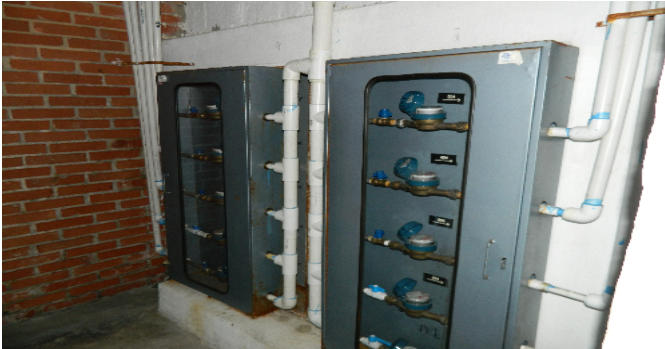
Contador de Agua
