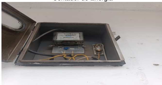
Contador de Energia
