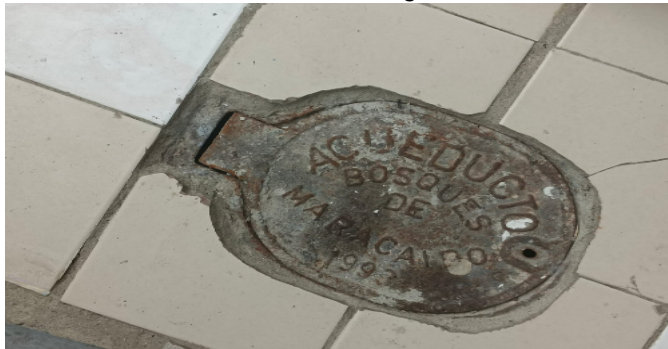
Contador de Agua
