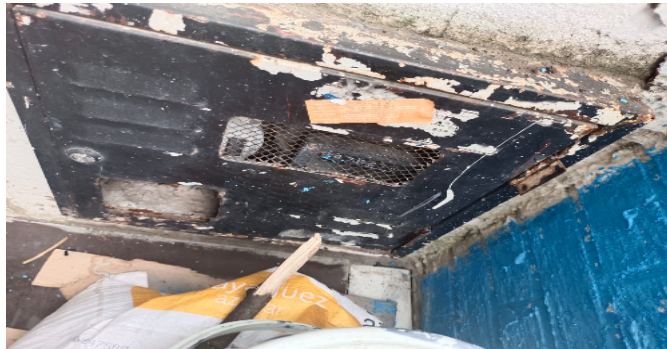
Contador de Gas
