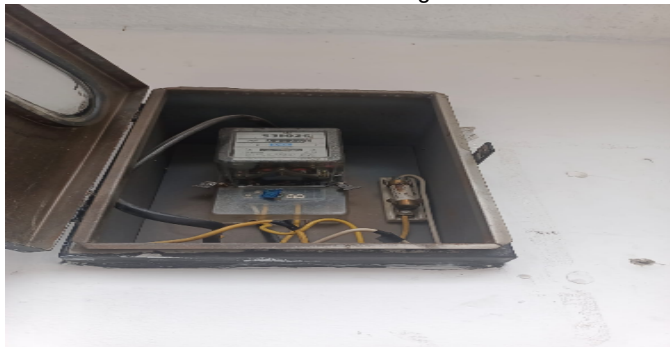
Contador de Energia
