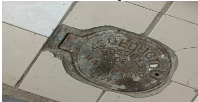
Contador de Agua
