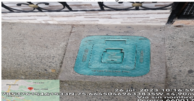
Contador de Agua
