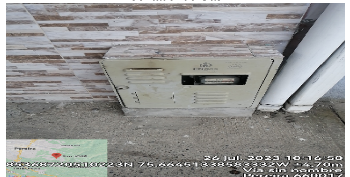
Contador de Gas
