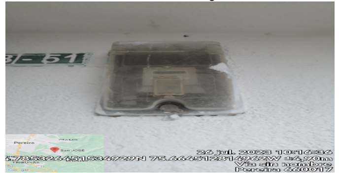
Contador de Energia
