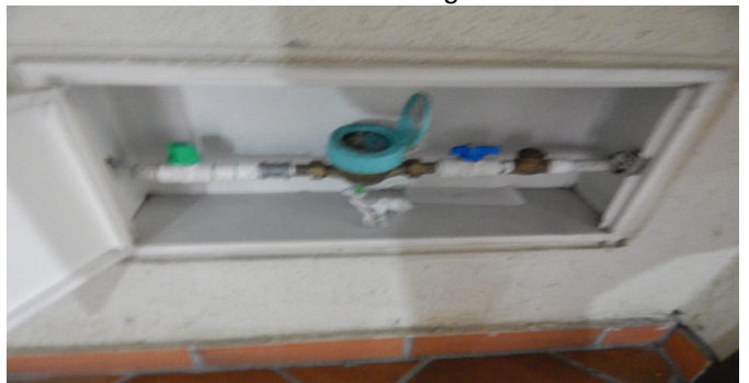
Contador de Agua
