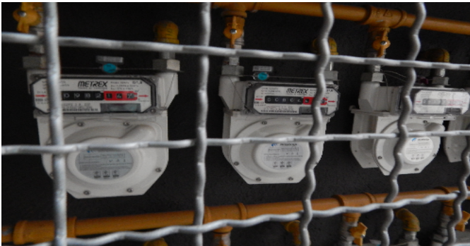
Contador de Gas
