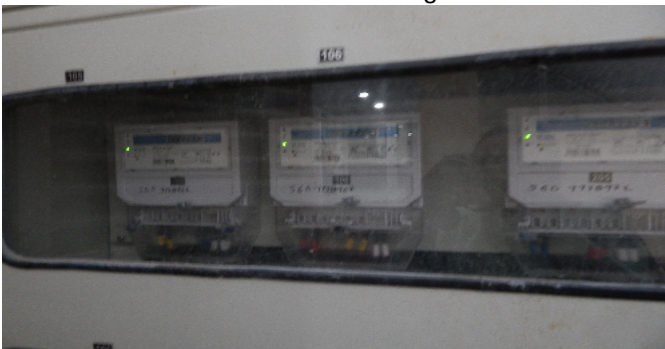
Contador de Energia
