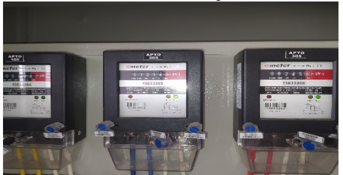
Contador de Energia
