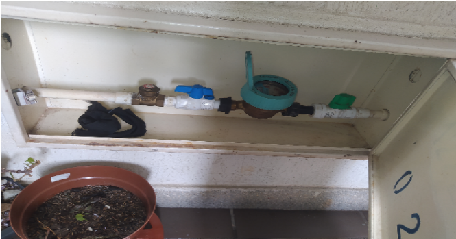
Contador de Agua
