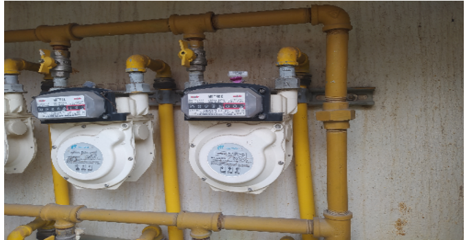
Contador de Gas
