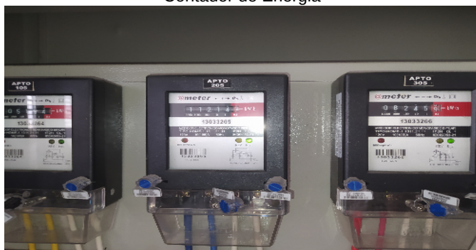
Contador de Energia
