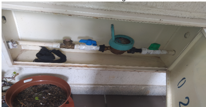
Contador de Agua
