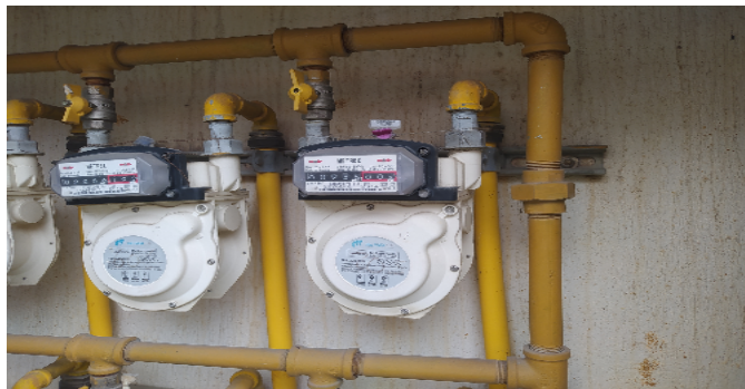
Contador de Gas
