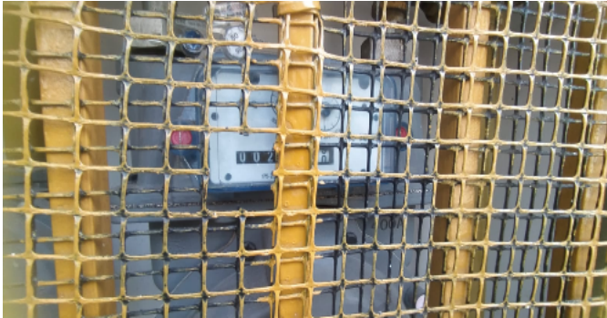
Contador de Gas
