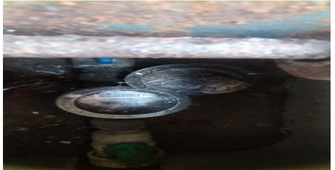
Contador de Agua
