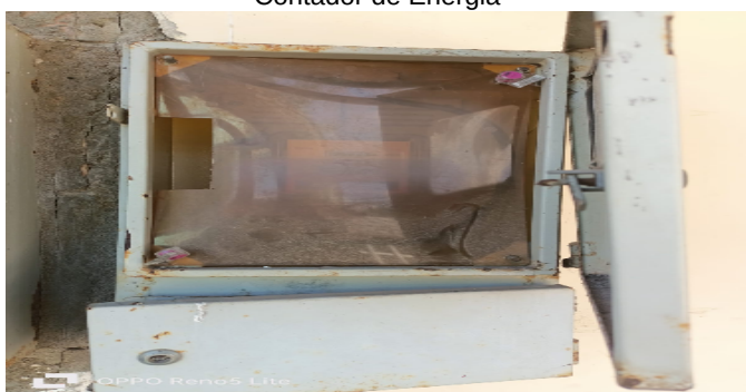
Contador de Energia
