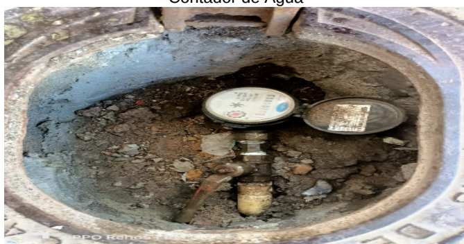
Contador de Agua
