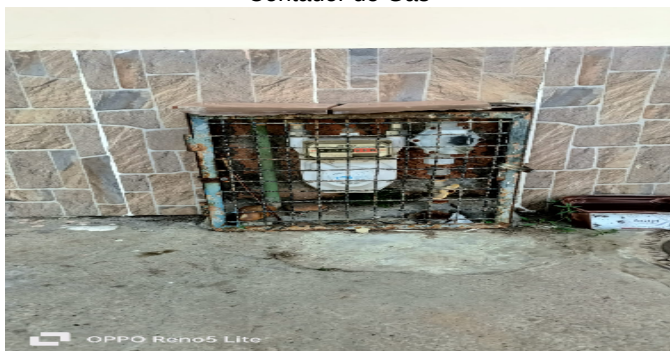
Contador de Gas
