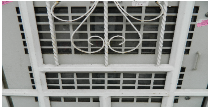
Contador de Energia
