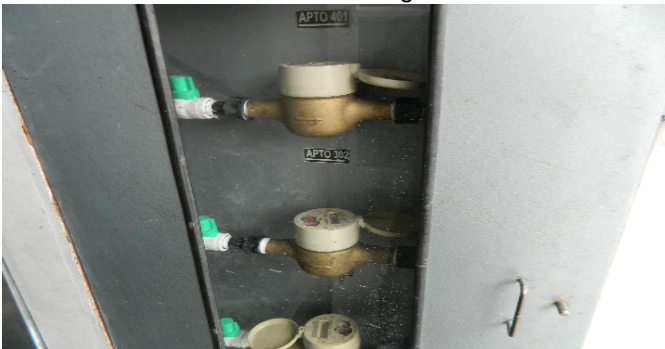
Contador de Agua
