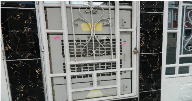
Contador de Energia
