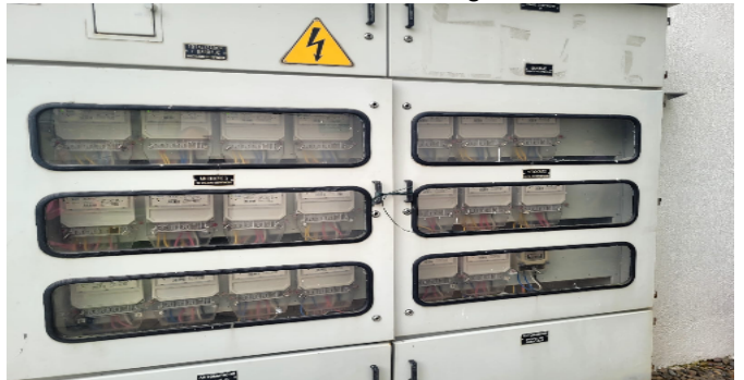
Contador de Energia
