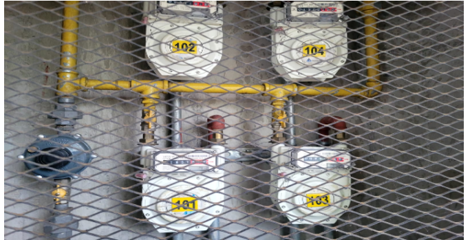
Contador de Gas
