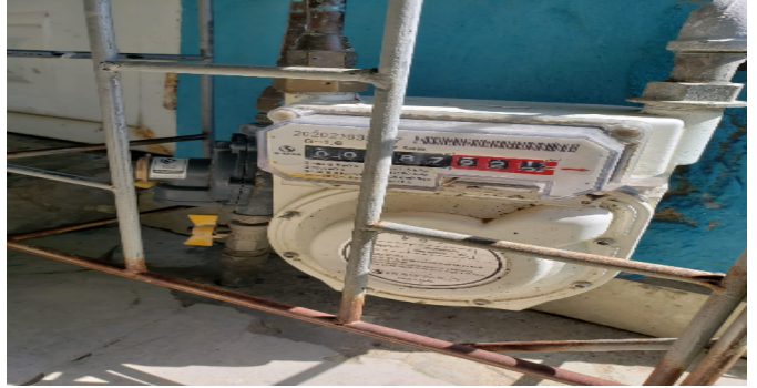
Contador de Gas
