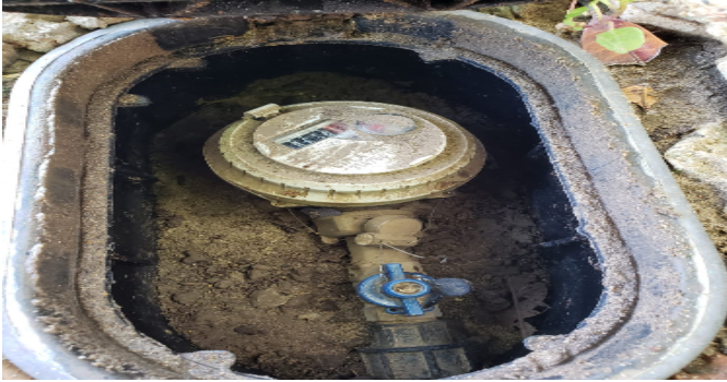
Contador de Agua
