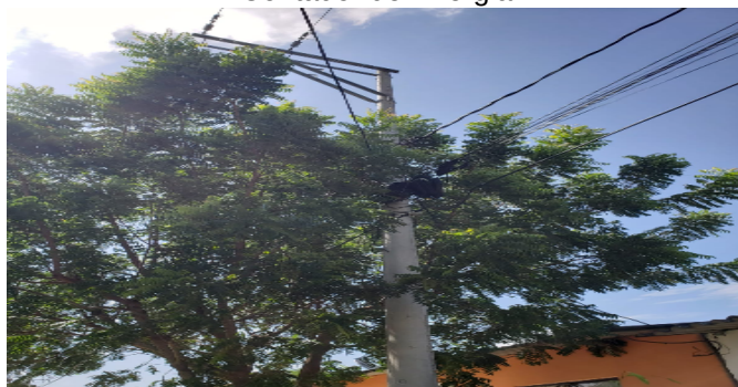
Contador de Energia
