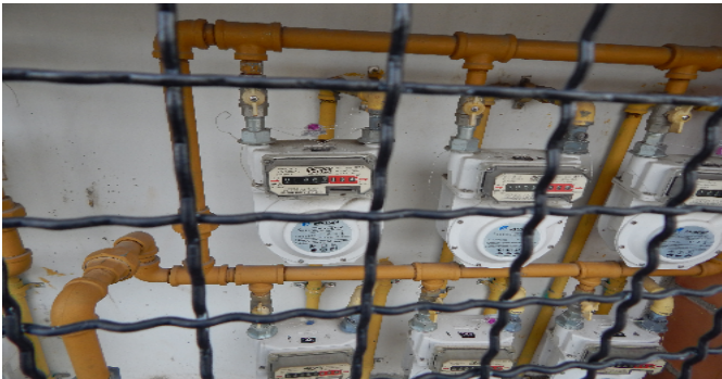
Contador de Gas
