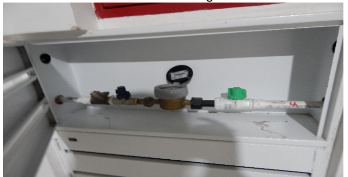
Contador de Agua
