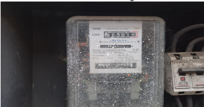
Contador de Energia
