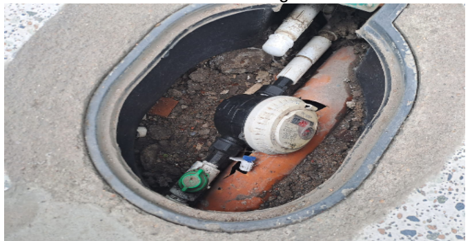
Contador de Agua
