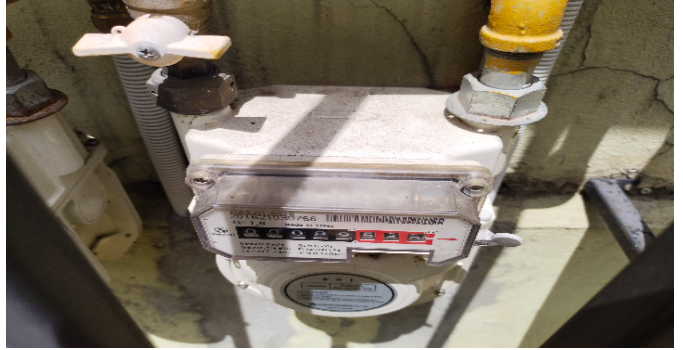
Contador de Gas
