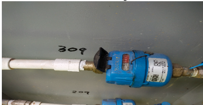
Contador de Agua
