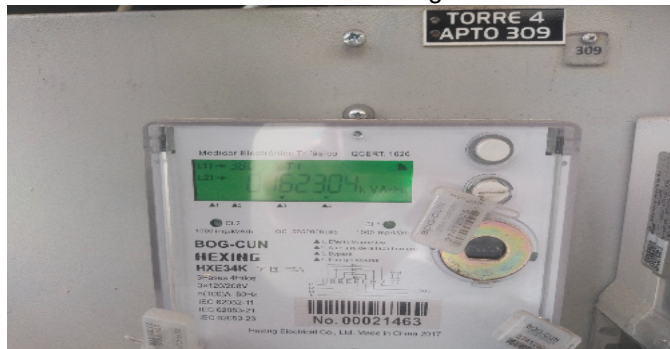
Contador de Energia
