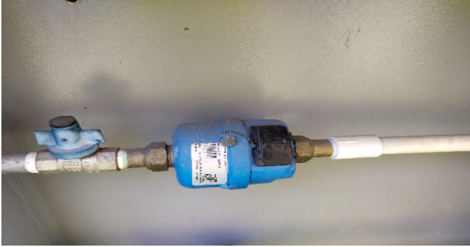
Contador de Agua
