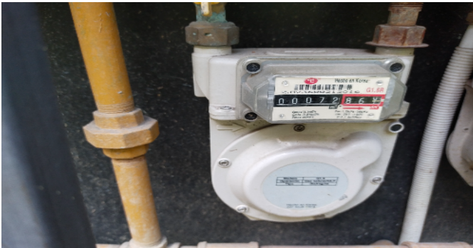
Contador de Gas
