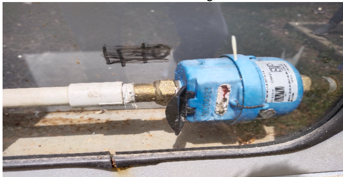
Contador de Agua
