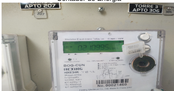
Contador de Energia
