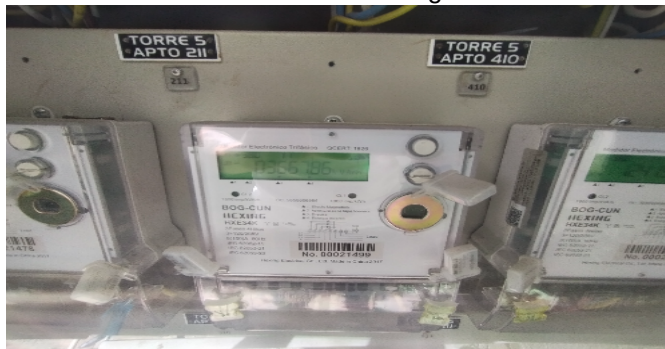
Contador de Energia
