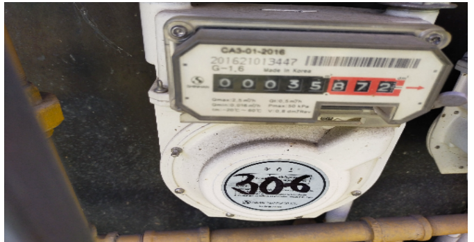
Contador de Gas
