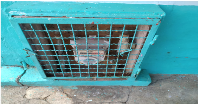
Contador de Gas
