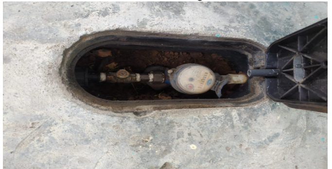
Contador de Agua
