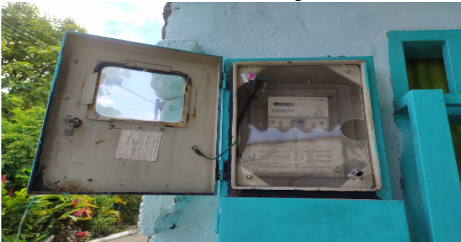
Contador de Energia
