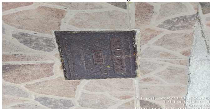
Contador de Agua
