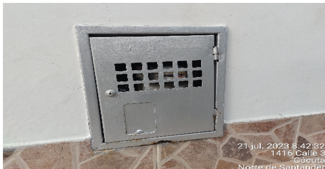
Contador de Gas
