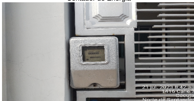
Contador de Energia
