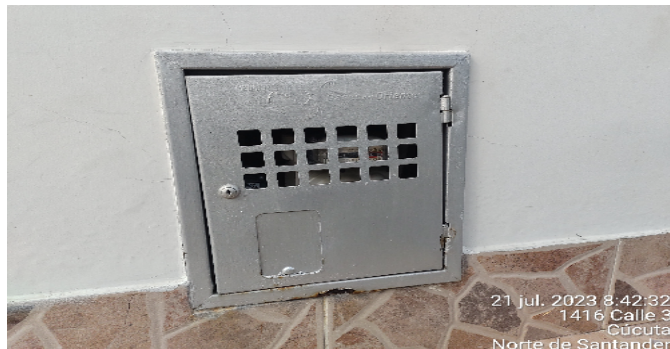
Contador de Gas
