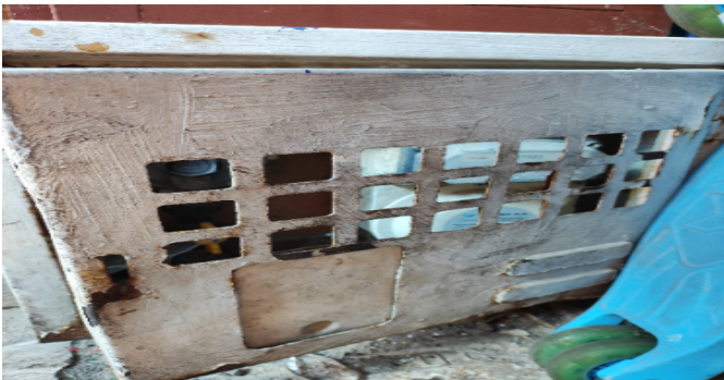
Contador de Gas
