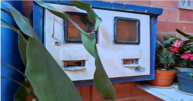
Contador de Energia
