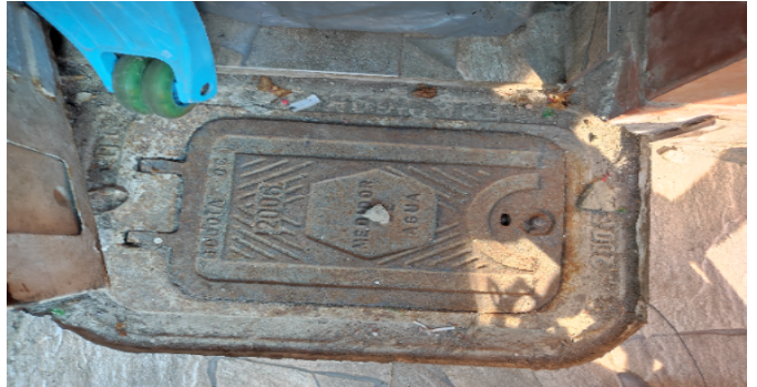
Contador de Agua
