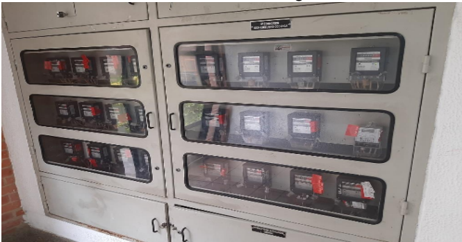
Contador de Energia
