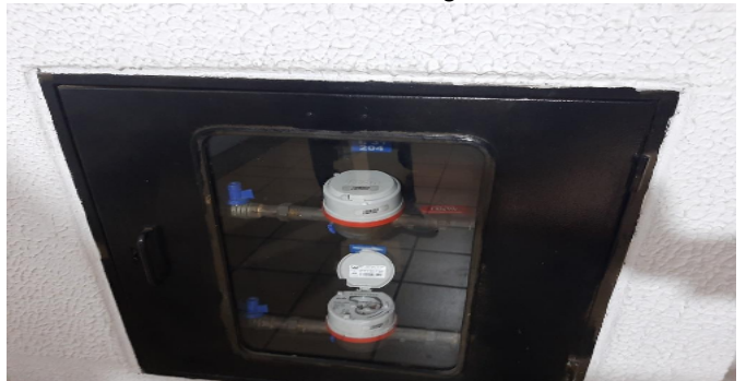
Contador de Agua
