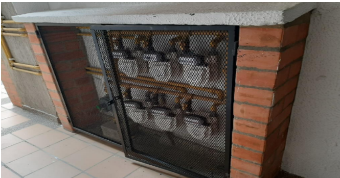
Contador de Gas
