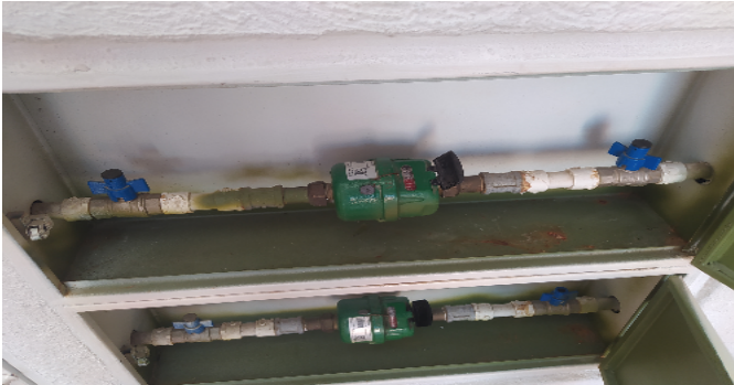
Contador de Agua
