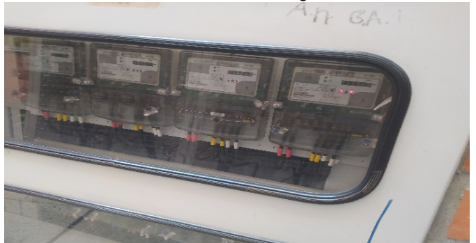
Contador de Energia
