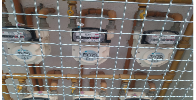
Contador de Gas
