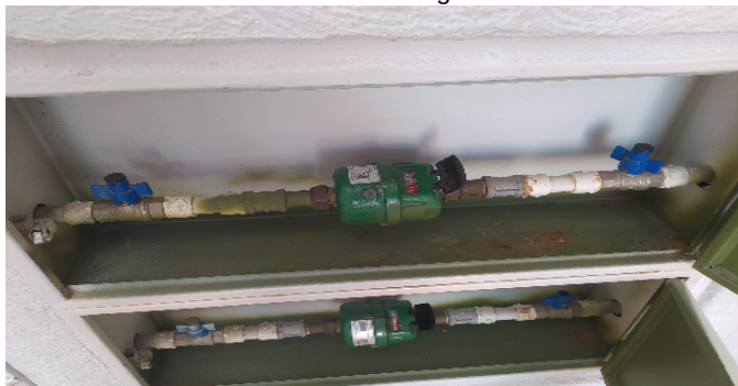
Contador de Agua
