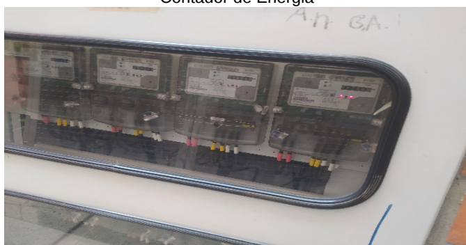
Contador de Energia
