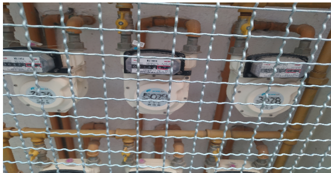
Contador de Gas
