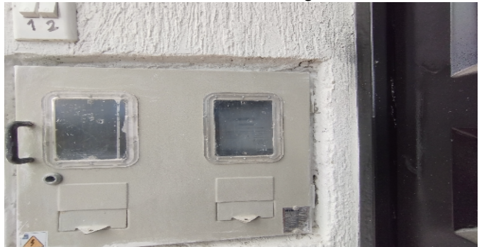
Contador de Energia
