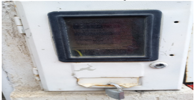
Contador de Energia
