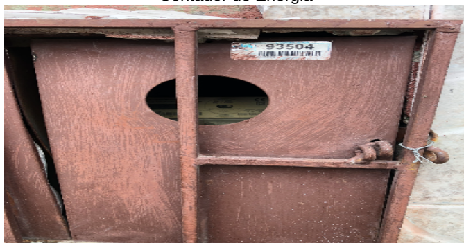
Contador de Energia
