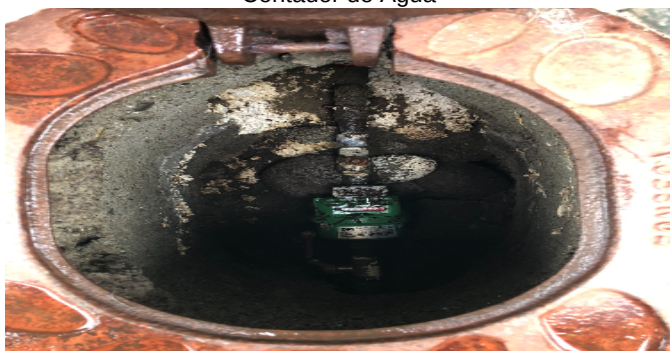
Contador de Agua
