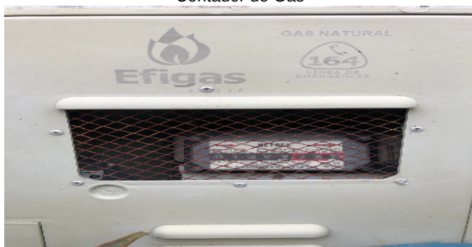
Contador de Gas
