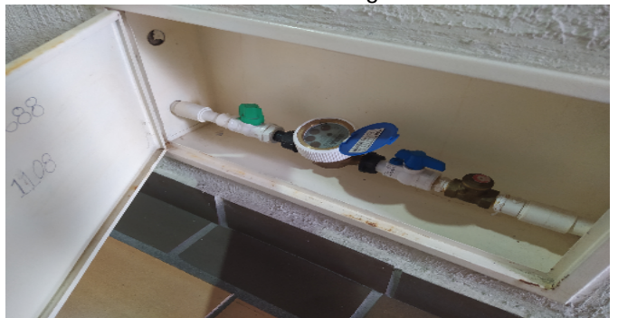
Contador de Agua
