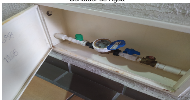
Contador de Agua
