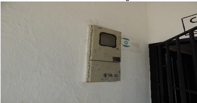
Contador de Energia
