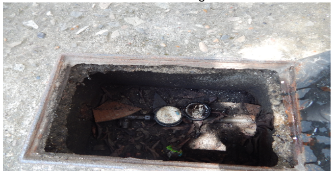
Contador de Agua
