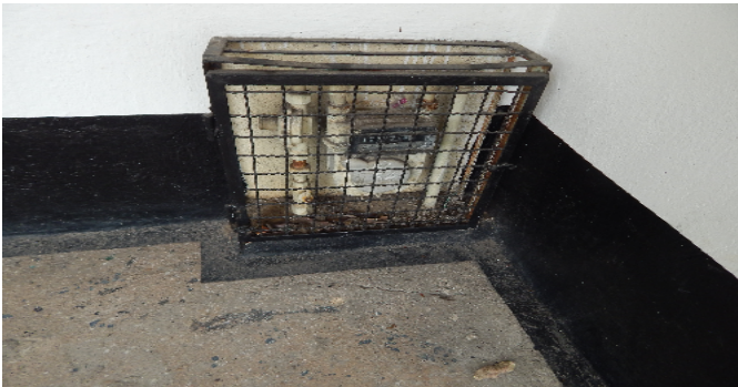
Contador de Gas
