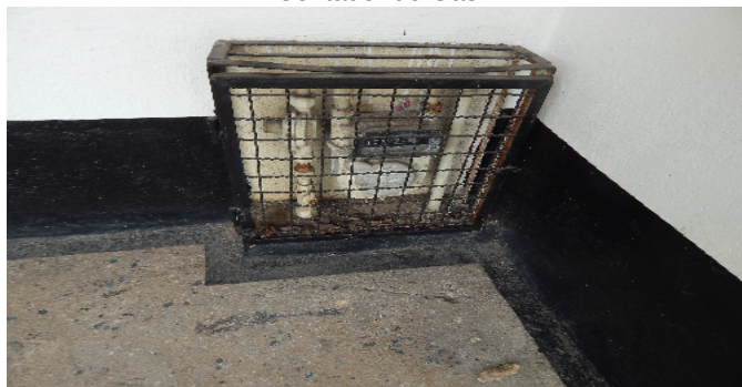
Contador de Gas
