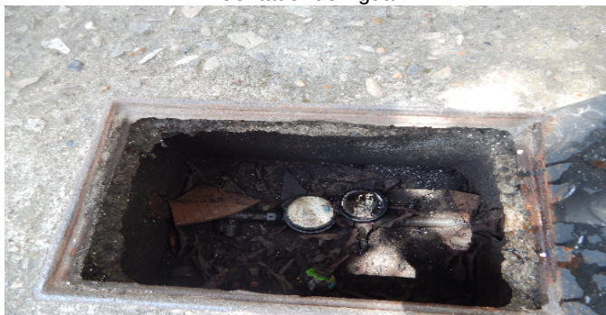
Contador de Agua
