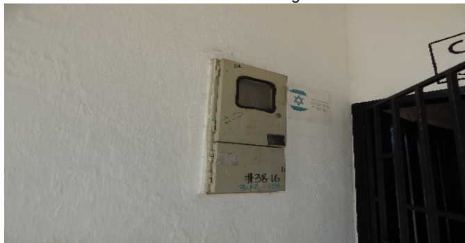
Contador de Energia
