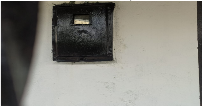
Contador de Energia
