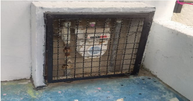
Contador de Gas
