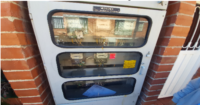
Contador de Energia
