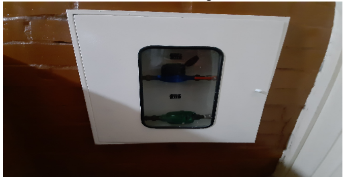
Contador de Agua
