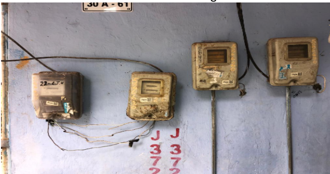
Contador de Energia
