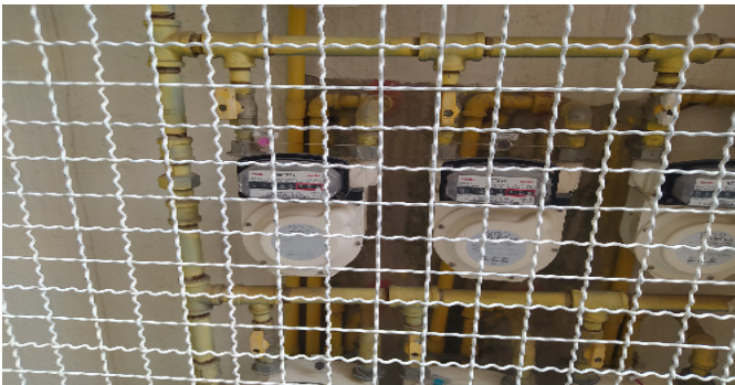
Contador de Gas
