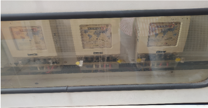
Contador de Energia
