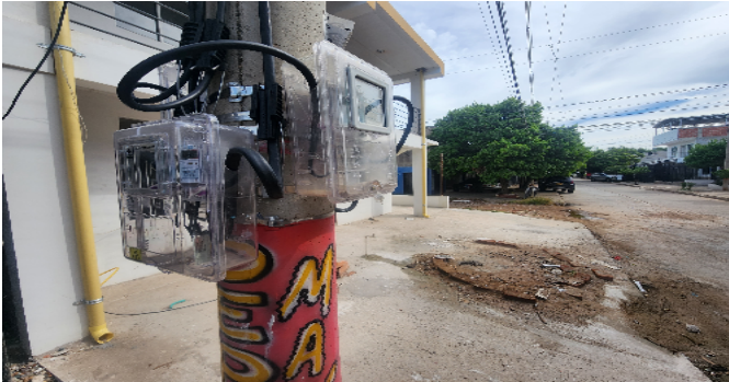
Contador de Energia
