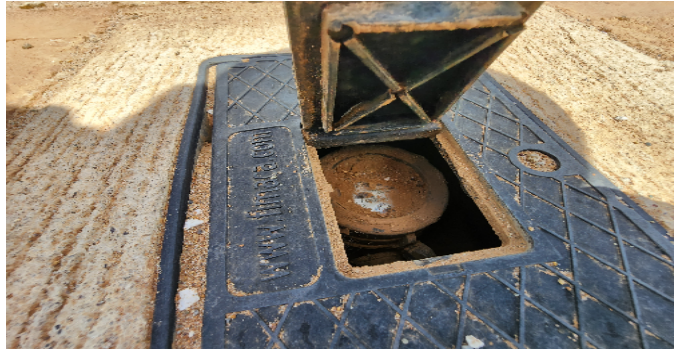
Contador de Agua
