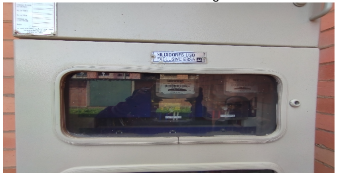
Contador de Energia
