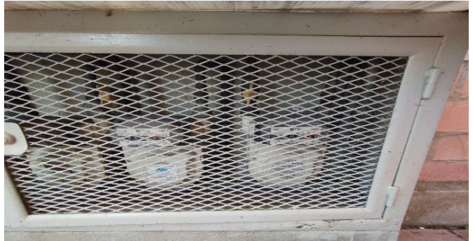
Contador de Gas
