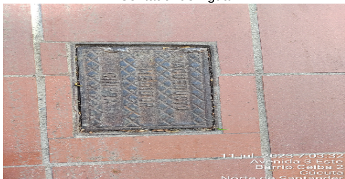
Contador de Agua
