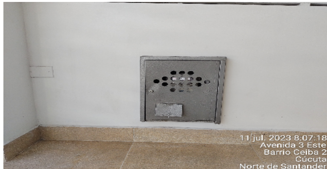
Contador de Gas
