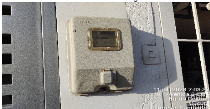
Contador de Energia
