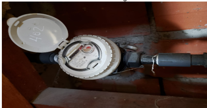
Contador de Agua
