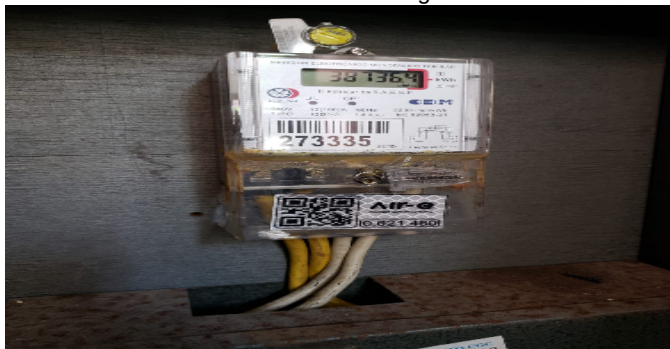
Contador de Energia
