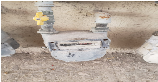
Contador de Gas
