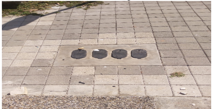
Contador de Agua
