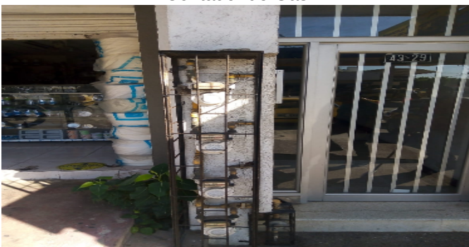
Contador de Gas
