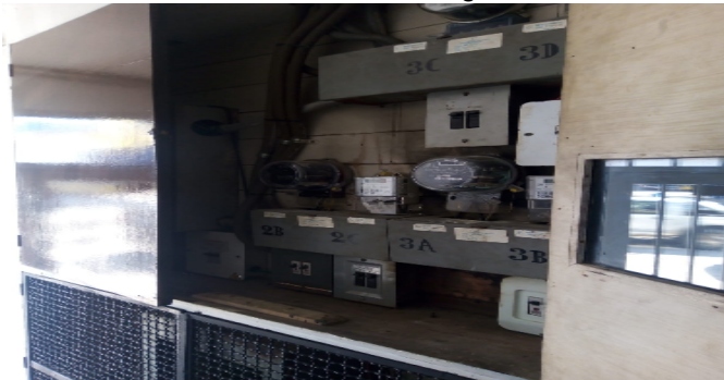
Contador de Energia
