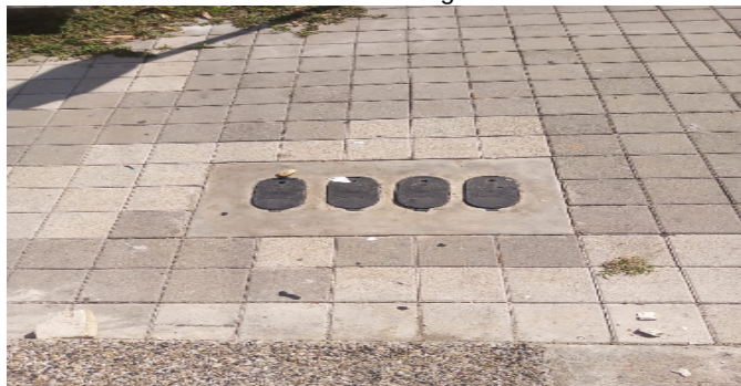
Contador de Agua
