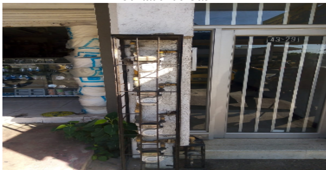
Contador de Gas
