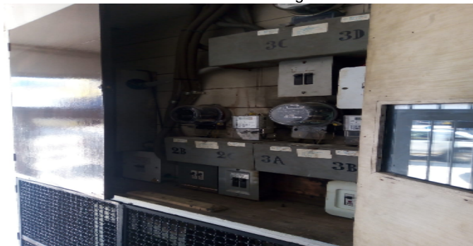
Contador de Energia
