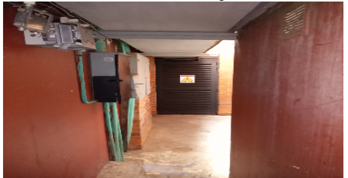
Contador de Energia
