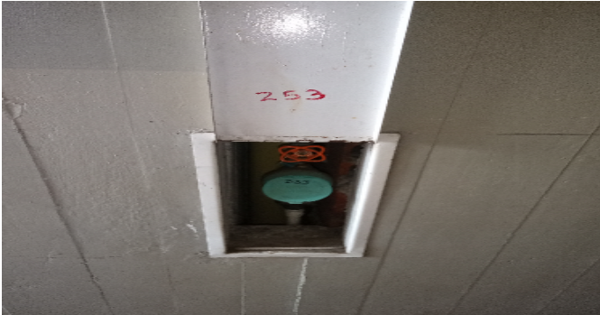
Contador de Agua
