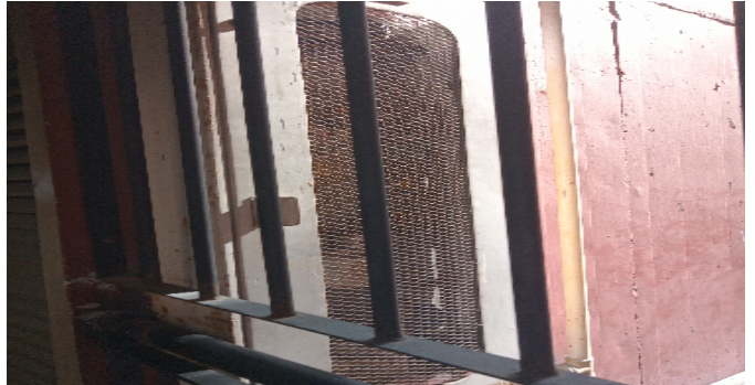
Contador de Gas
