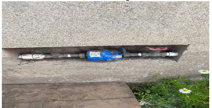
Contador de Agua
