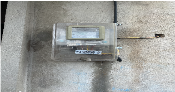
Contador de Energia
