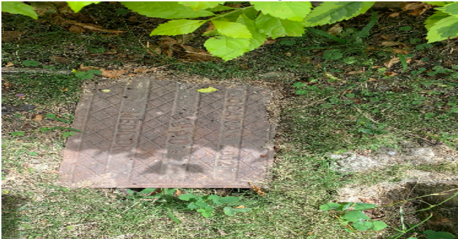
Contador de Agua
