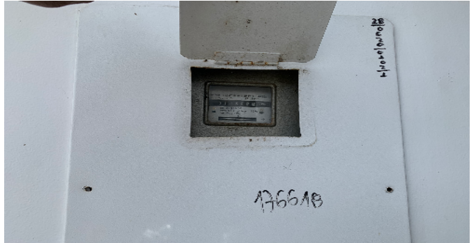
Contador de Energia
