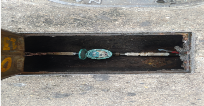
Contador de Agua
