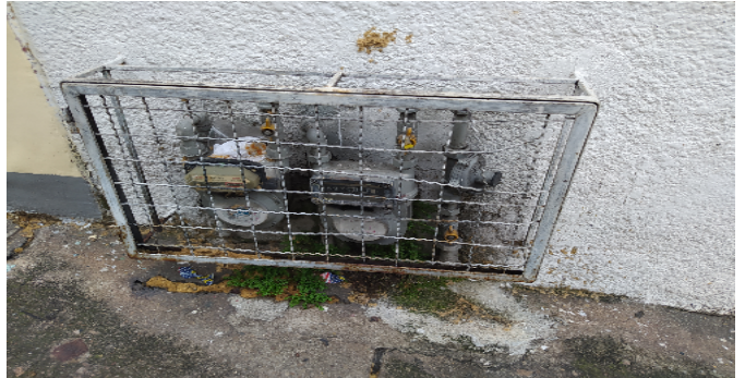
Contador de Gas
