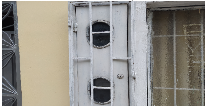
Contador de Energia
