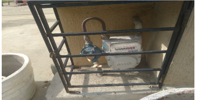
Contador de Gas
