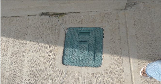
Contador de Agua
